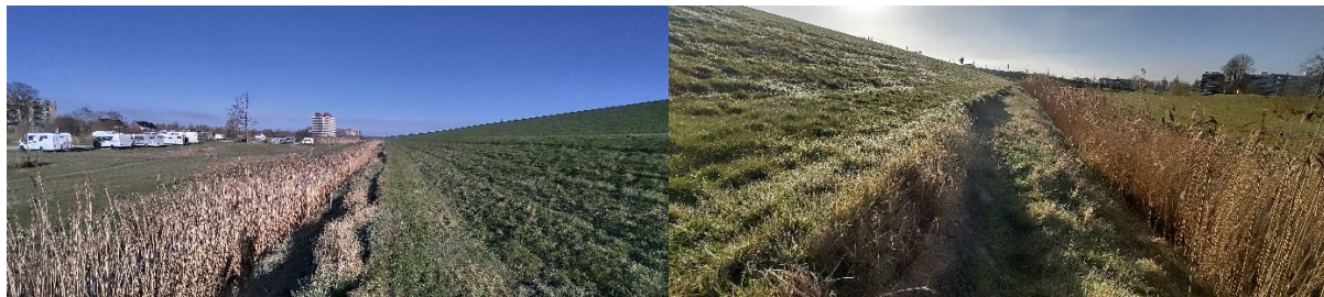
Figuur 4 afgeschoven talud binnenteensloot Eemshotel
