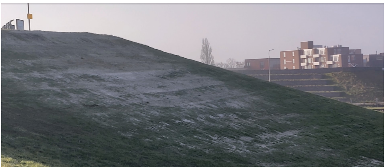
Figuur 3 zandoverstuiving ter plaatse van Marconistrand Delfzijl
