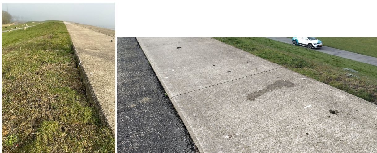
Figuur 5 Verzakking langs fietspad iets ten noorden van het Voolhok
