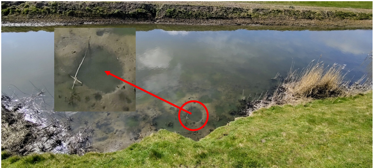
Figuur 11 afschuiving kort ten oosten van de Noordkaap
