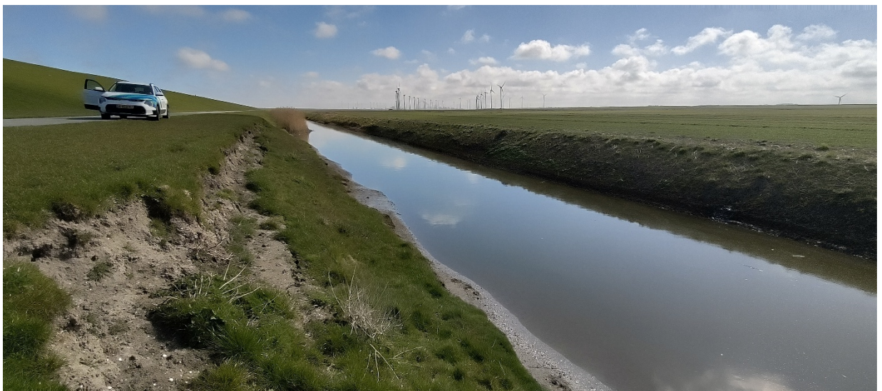
Figuur 10 Afschuiving talud binnenteensloot Emmapolder (Uithuizermeeden en Uithuizen)
