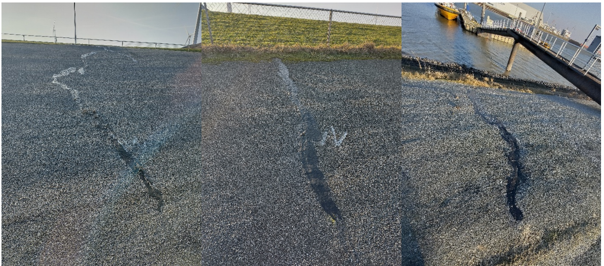
Figuur 9 Met vloeibaar bitumen dicht gegoten scheuren in asfaltbekleding Eemshaven
