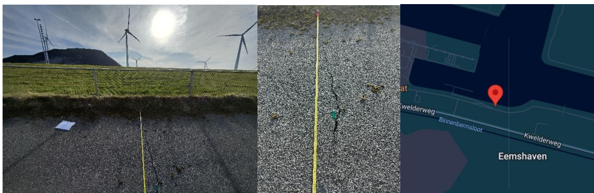
Figuur 44 Verscheurde asfaltbekleding ter plaatse van de Eemshaven (maart 2025)
