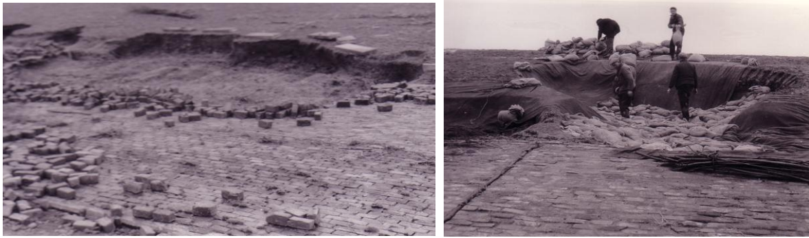
Figuur 6 Schade aan kering ten gevolge van storm in 1962
