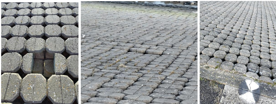
Figuur 10 kapotte steenbekleding type Hillblock ter plaatse van het Voolhok
