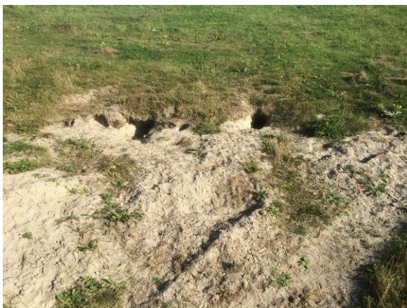
Konijnschade aan het buitentalud
