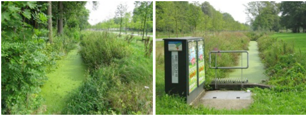
Figuur 4.5: Slechte doorstroming watergang en gemaal Concourslaan
