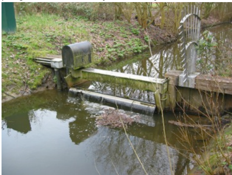
Figuur 4.1: Geautomatiseerde stuw
