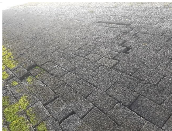
Figuur 8. Lokale verzakkingen betonblokken.
