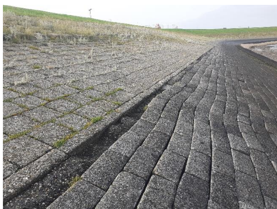
Figuur 7. Verzakking koperslakblokken t.o.v. betonband.
